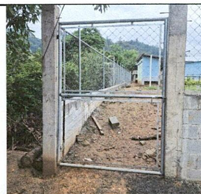
Foto 4: Evidencia la necesidad de mejoramiento del portón y puerta de acceso al establecimiento
