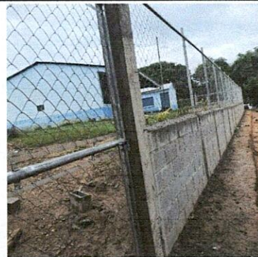
Foto 2: Fotografía evidencia la necesidad del muro perimetral
