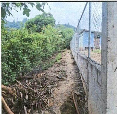
Foto 3: Evidencia la necesidad de muro perimetral
